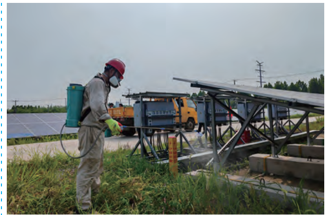
近日,在沧海包装2.34MW分布式光伏运维项目现场,供电公司顺利完成阶段维保任务,保障光伏设备可靠运行发电。(王雨)
